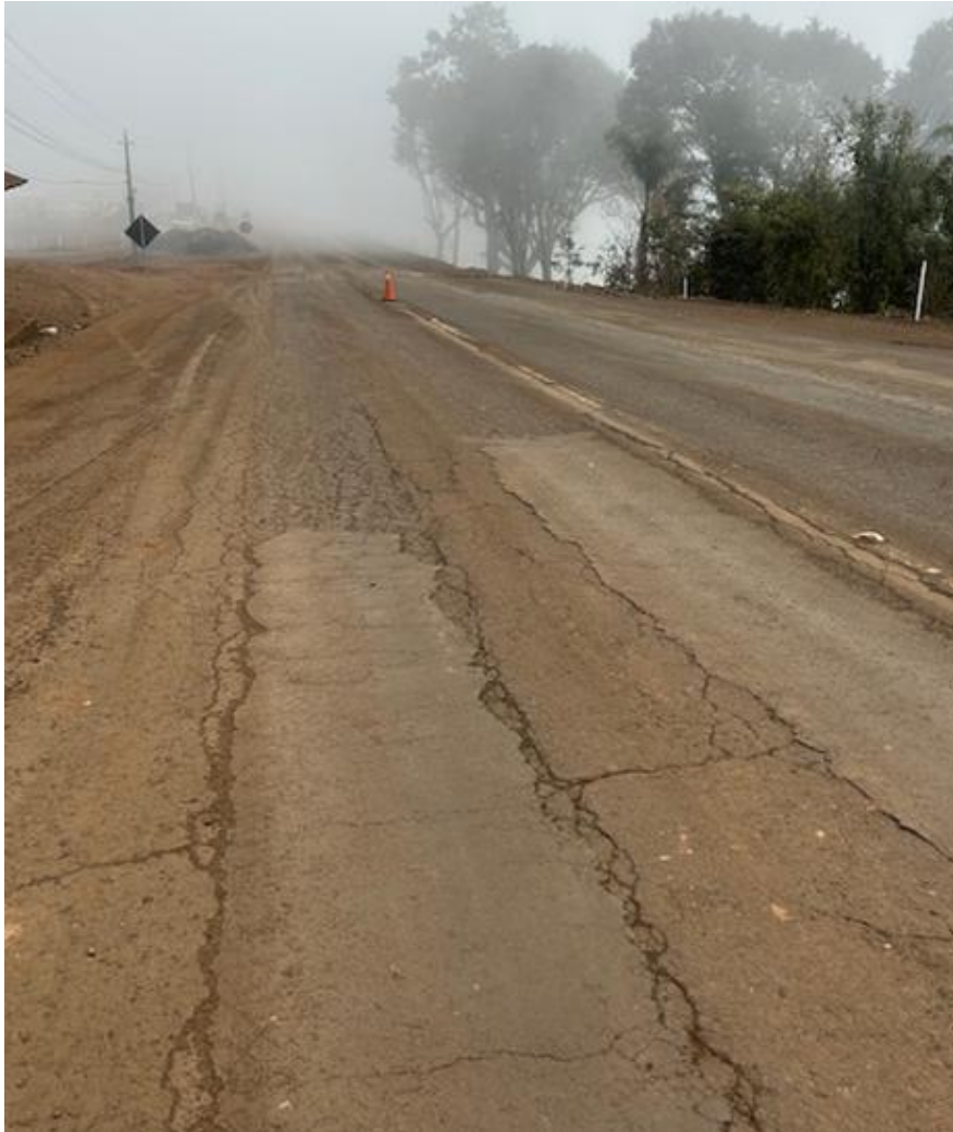
28 - Desagregação do pavimento no km 59,00
