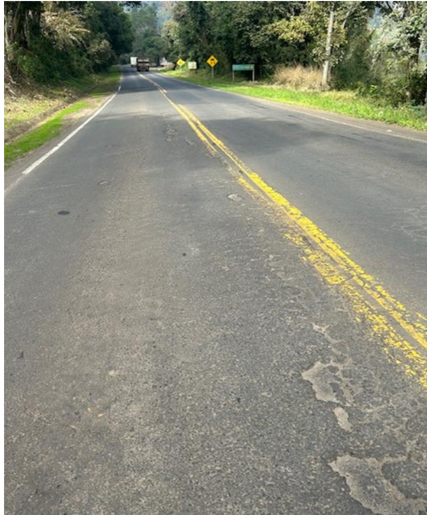
31 - Situação do pavimento próximo ao acesso Arabutã, que se repete em outros pontos
