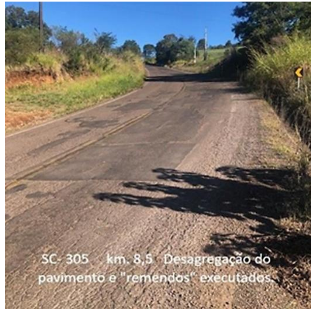
4 – Situação do pavimento no km 8,5 no ano de 2021
