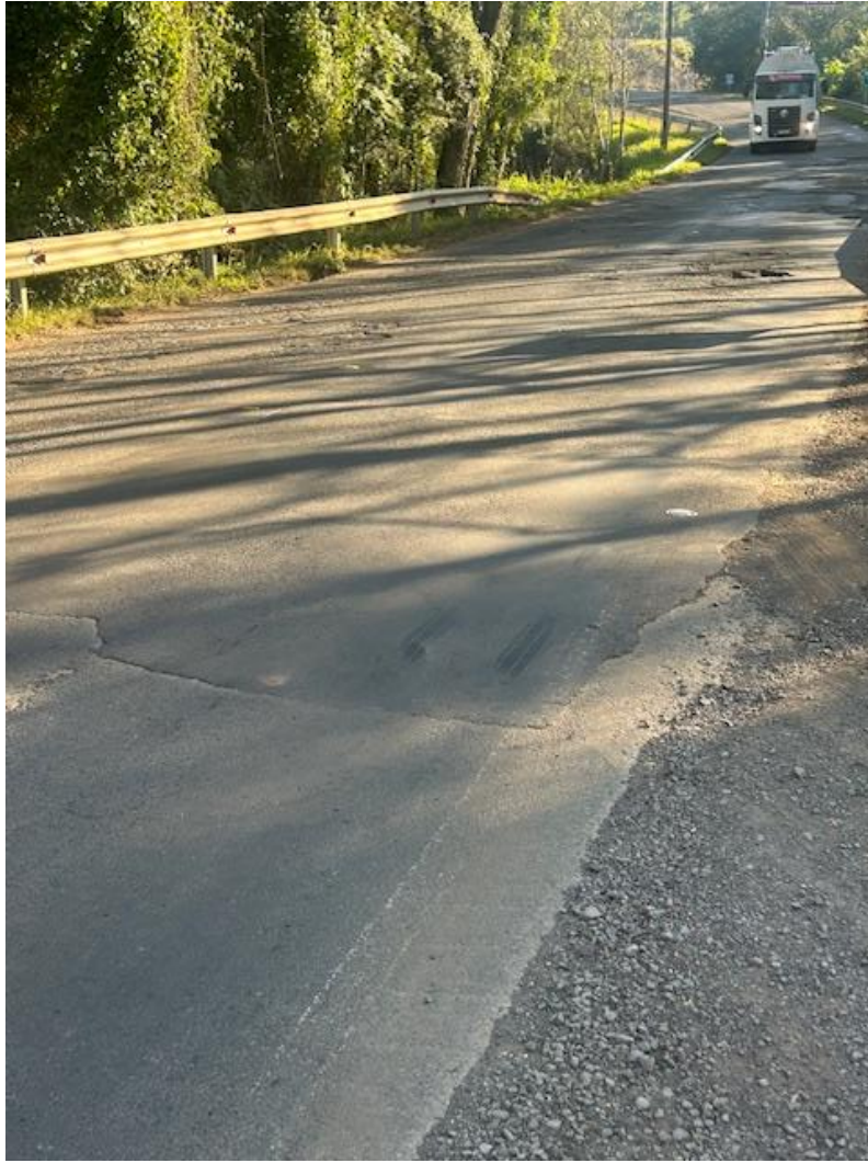
17 - Situação do pavimento no km. 165,50
