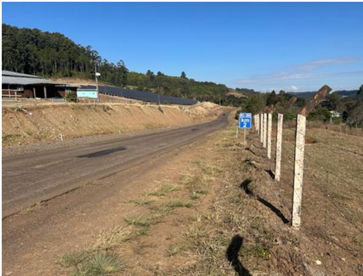
1 – Situação do pavimento atual nos kms 1,80 e 2,00
