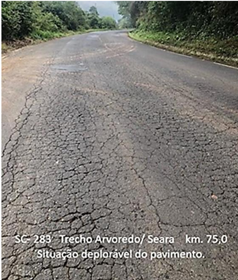
22 – Situação do pavimento no km 75 no ano de 2021
