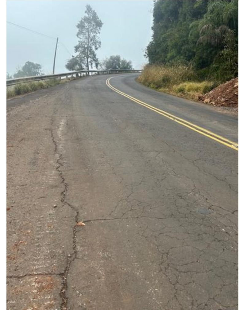
27 - Situação do pavimento no km 60,30
