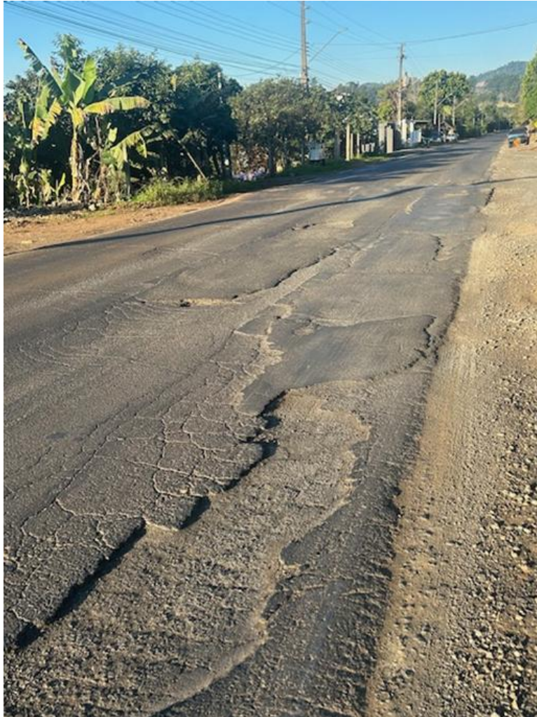
19 - Situação do pavimento entre Águas de Chapecó e Planalto Alegre. Se repete ao longo de 1.800 metros
