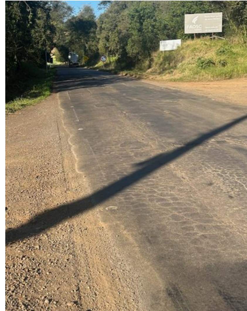
18 - Afundamento e recalque na pista - km. 165,80
